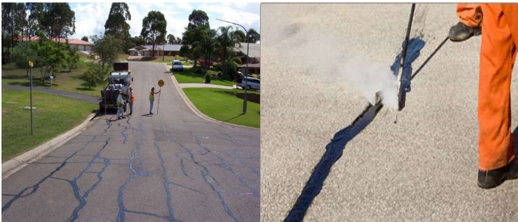
Слика 93: Санација на пукнатини завршна обработка
