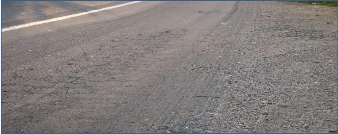
Слика 92: Оштетувања на коловозната конструкција поради замор – „крокодилска кожа“ на патот А4 делница: „Скопје – Блаце“
