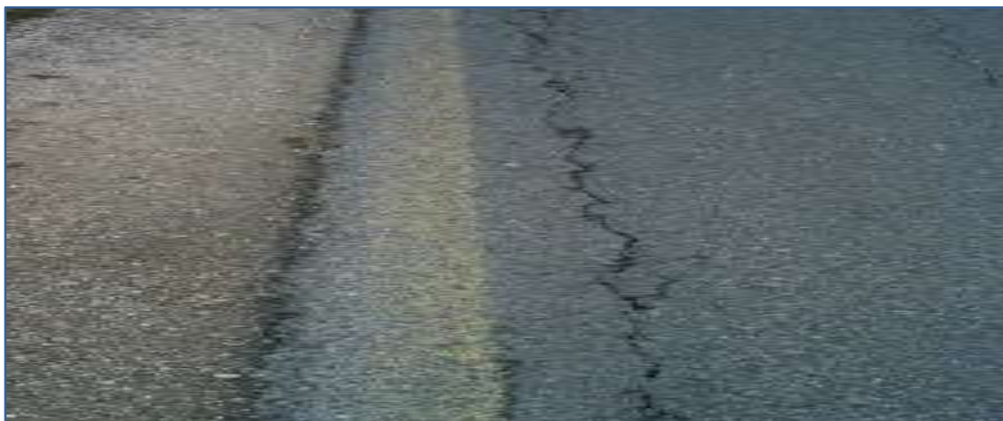
Слика 79: Пукнатини по работ на коловозната конструкција
