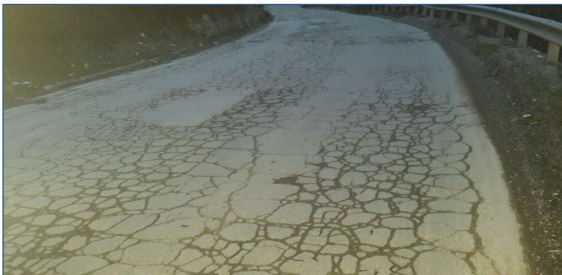
Слика 74: Оштетување поради замор на коловозната конструкција т.н. „Крокодилска кожа“ на патот Р1202 (кај с. Рајчица - Дебар)
