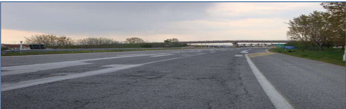
Слика 90: Блок пукнатини и надолжни пукнатини во трагата на движење од тркалата на автопатот А4 делница: „Петровец – Скопје“
