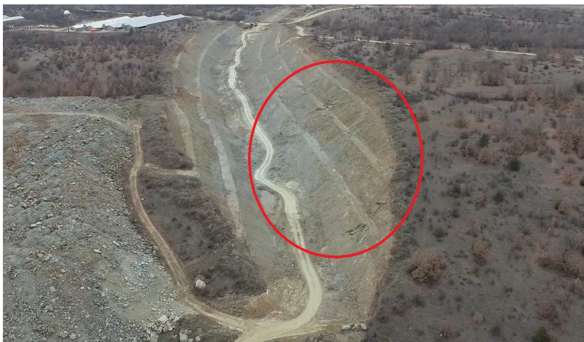
Слика 123 Состојба на усек 4 март 2022. Со црвена боја е означена локалната нестабилност на десната страна на усекот
