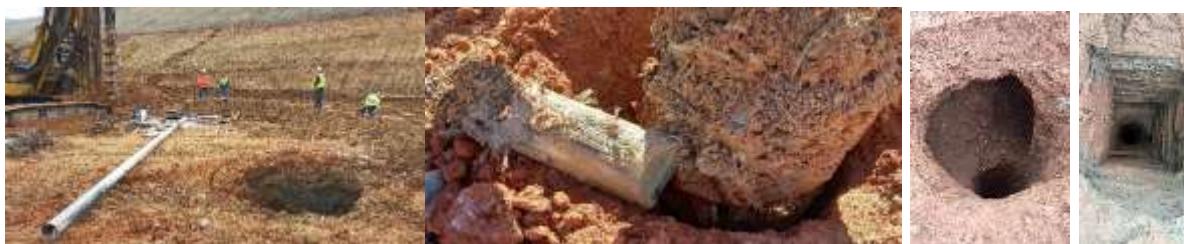
Слика 10. а) дрвена подграда б) колапс на земјиште при дупчење в) страничен отвор при дупчење г) вентилационо окно со подграда
