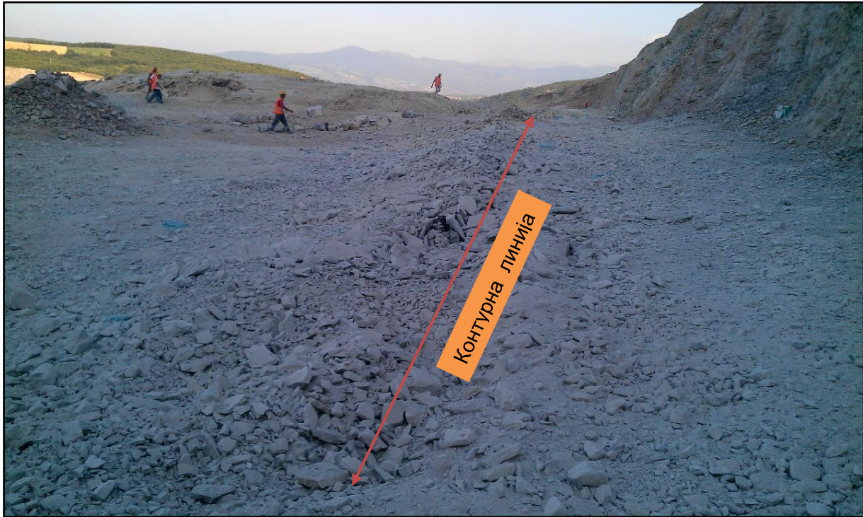
Слика 8.1. Поглед на контурно минирање без примарни дупки Figure 8.1. View of contour blasting without production drillings
