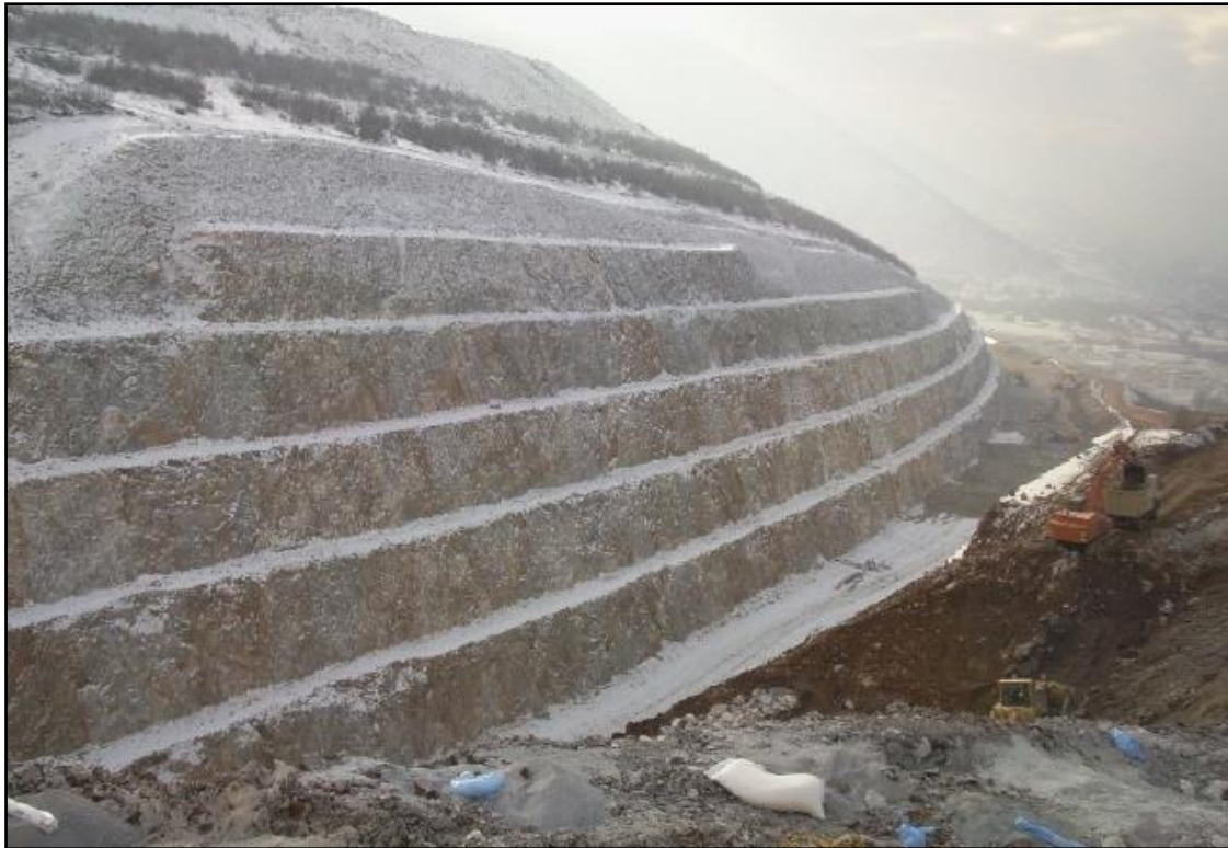
Слика 8.11. Поглед на етажите, формирани од експлозии при контурно минирање на автопатот кај областа Жур Figure 8.11. View of the slopes, formed by contour blastings on motorway at Zhur
