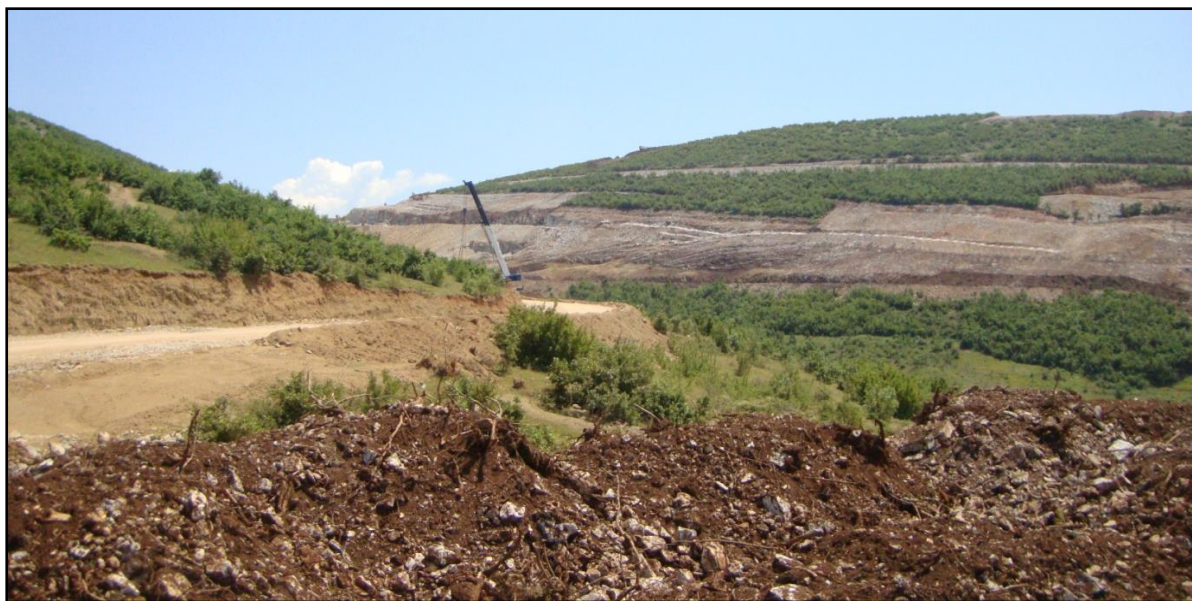
Слика 8.10. Поглед на етажите на падините за време на изградбата на автопатот во областа Жур
