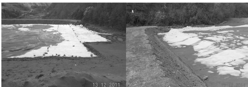
Слика 12. Поставеност на дренажниот геокмпозит
