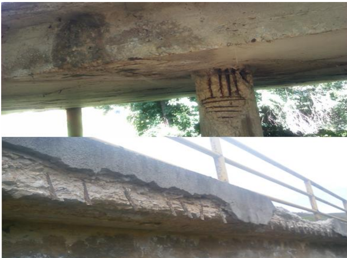
Слика 59. Последици од штетното влијание на патната сол врз бетонот и арматурата на армирано бетонските објекти
