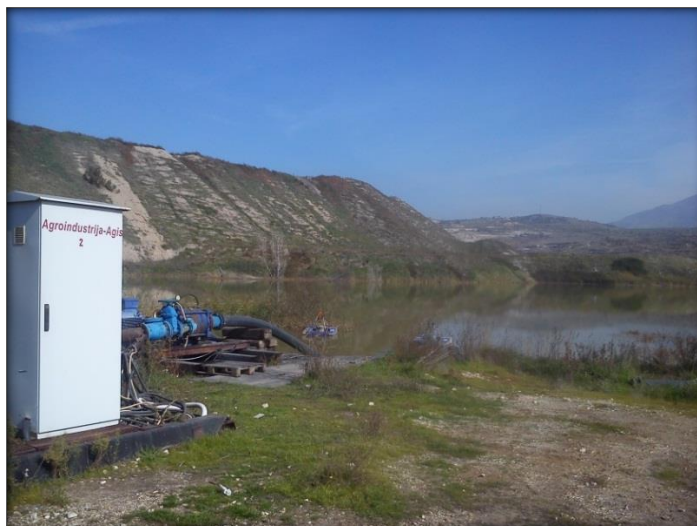
Слика 8. Централен водособирник со пумпна станица
